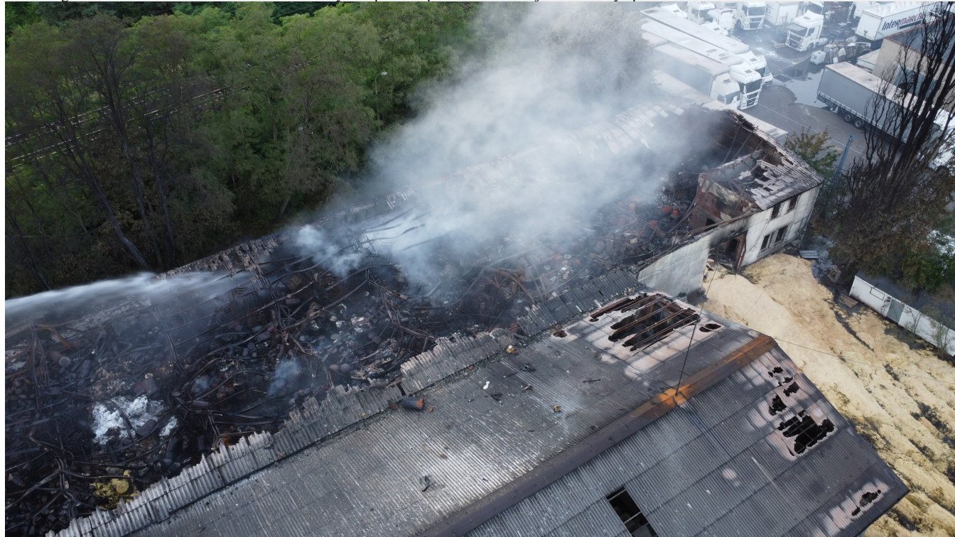
Fot.6 Pogorzelnisko Przylep po opanowaniu pożaru, ale nadal z gazami odprowadzanymi do powietrza. To nie jest para wodna tylko toksyczna chmura z substancjami chemicznymi. Zniszczony dach z płyt azbestowo – cementowych hali w której były magazynowane odpady. Sąsiadujący obiekt budowlany z uszkodzonym dachem azbestowo – cementowym 13
