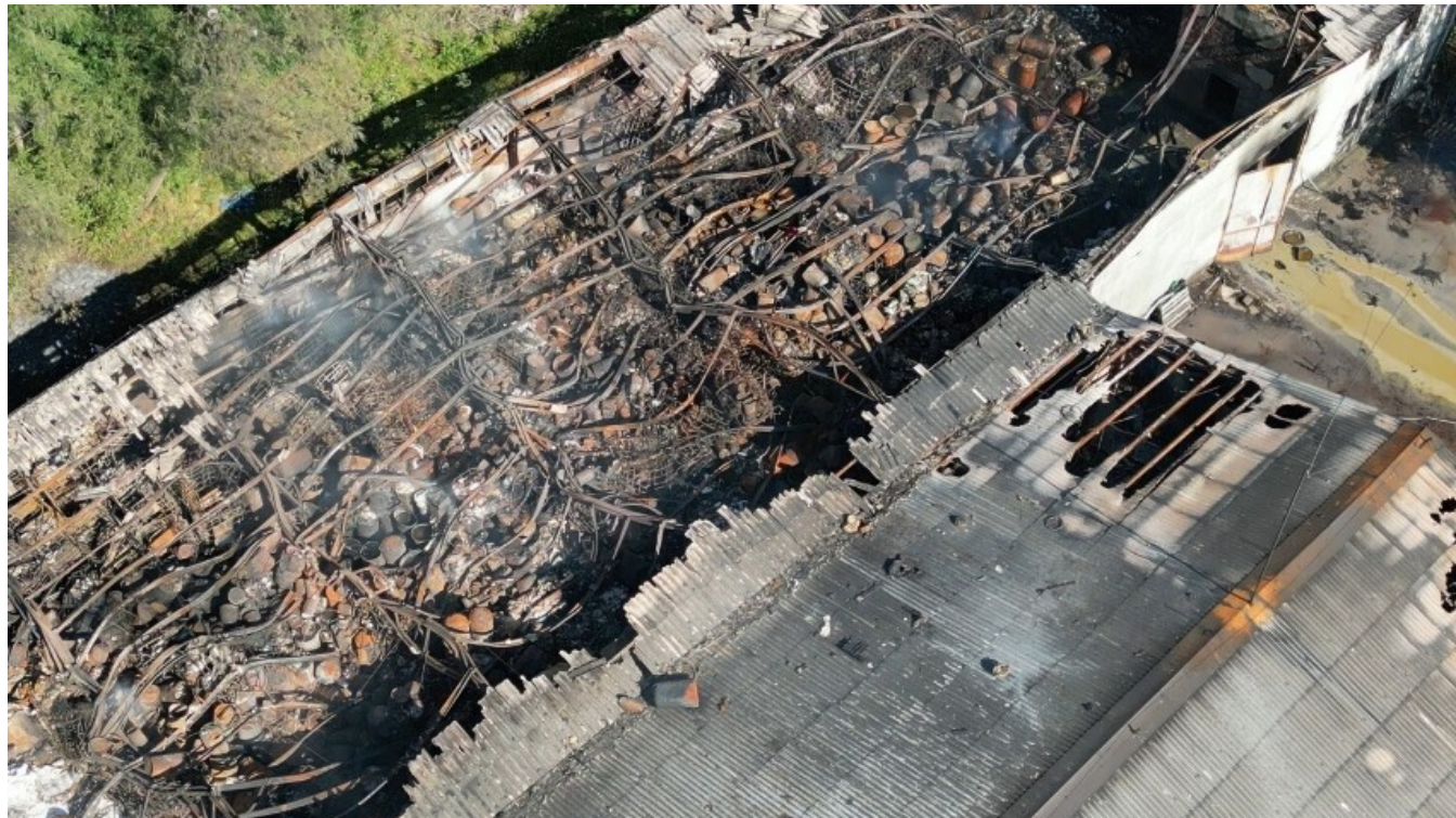
Fot.7 Pogorzelnisko Przylep. Zniszczony dach z płyt azbestowo – cementowych hali, w której były magazynowane odpady. Sąsiadujący obiekt budowlany z uszkodzonym dachem azbestowo – cementowym 14
