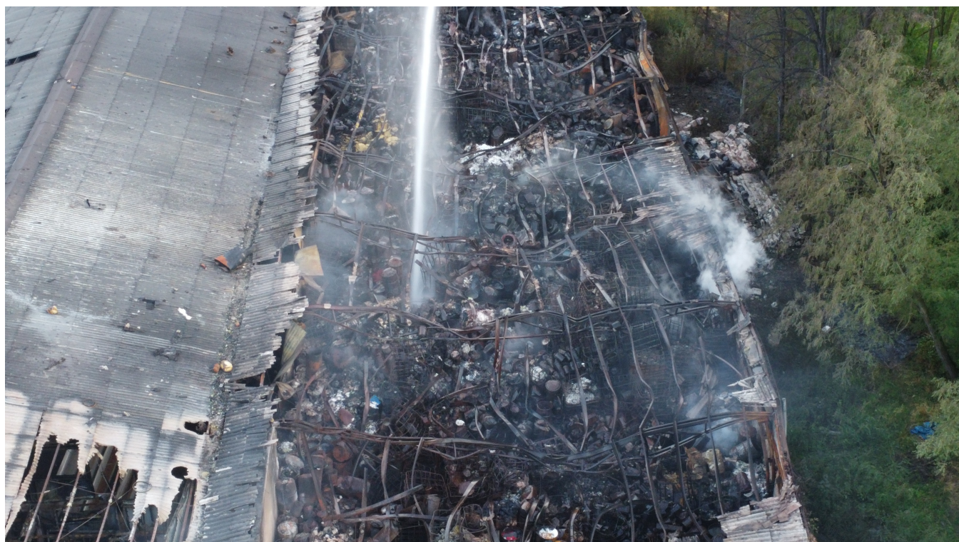
Fot.5 To nie jest para wodna tylko toksyczny dym z substancjami chemicznymi. Zniszczony dach z płyt azbestowo – cementowych hali w której były magazynowane odpady. Sąsiadujący obiekt budowlany z uszkodzonym dachem azbestowo – cementowym 12
